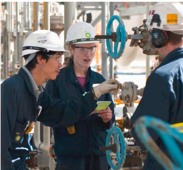
In der Raffinerie bei BP
